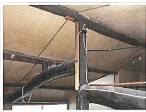
2階の配線だらけの梁 せっかくの梁がもったいない!
