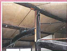
配線むき出しの梁
