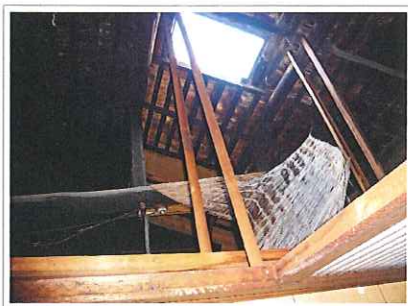
天井裏。 上ると底が 抜けます。
