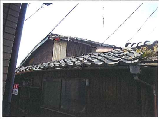
屋根も葺き替えしないとイケないくらいな状態です。
